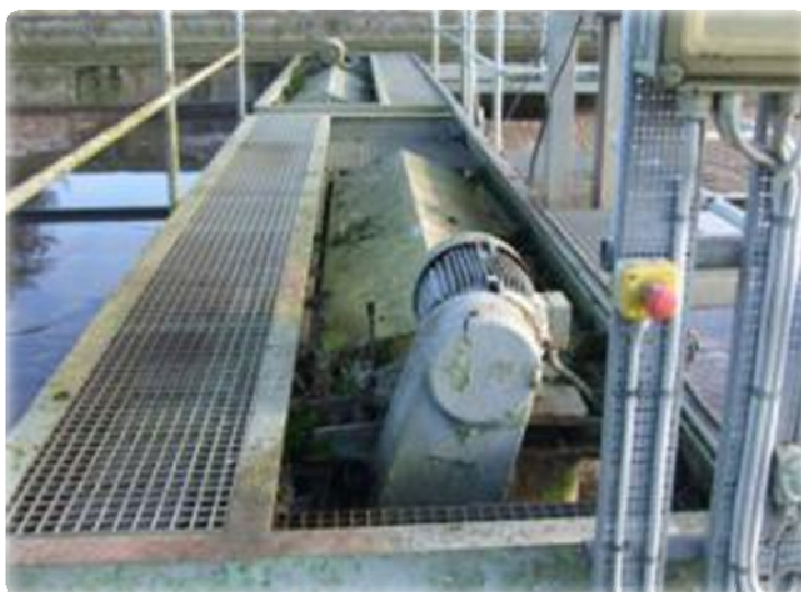
Adgangsbro til propelomrører i luftningstank, Dianalund
