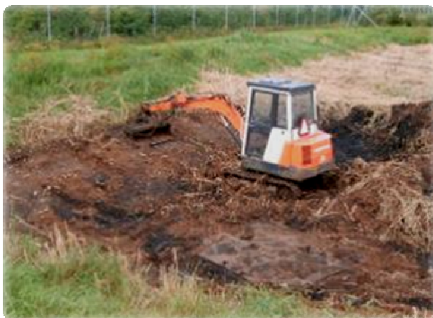
Eksempel på tømning af et slammineraliseringsanlæg
